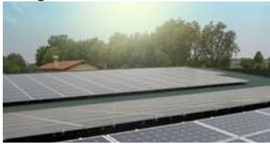
Neue Photovoltaik-Anlage mit einer 104 KW Stromstärke - Keller in Fossalta di Piave
